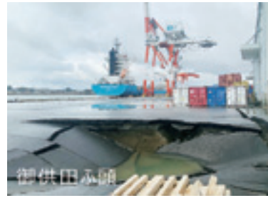
写真2 液状化による被災状況
