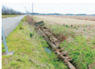
液状化による用水路の転倒
