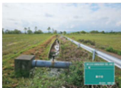
液状化による排水路等の損壊
