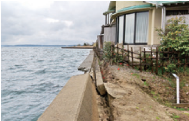
写真-1 被災した護岸と旅館との近接状況
